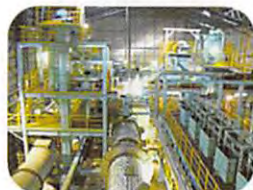
プラント設備
